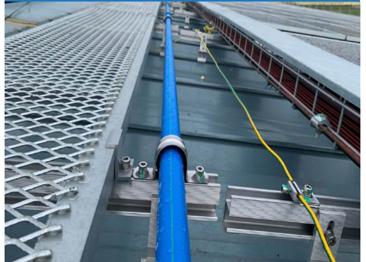
Hệ thống cấp nước vệ sinh
