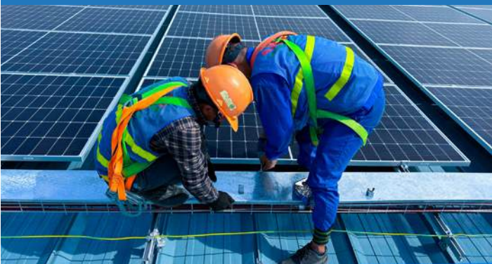
Đi máng dây điện an toàn
