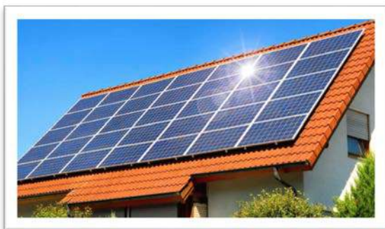
H.a: Điện mặt trời áp mái
