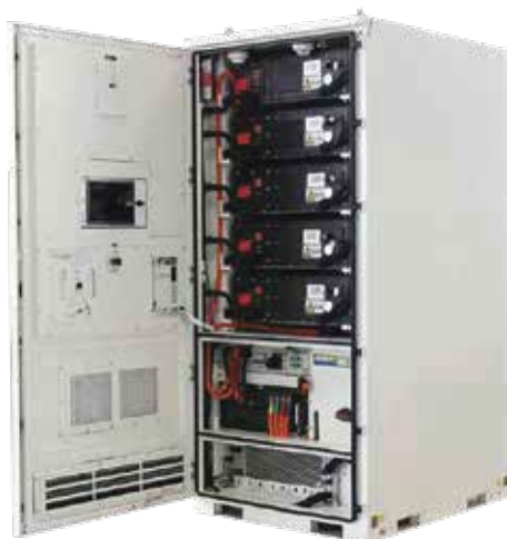
Tủ điện Pin Lithium 261kWh (PCS)
