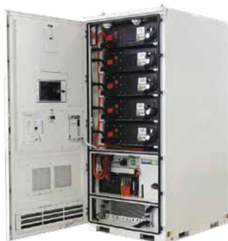
Tủ điện Pin Lithium 261kWh (PCS)
