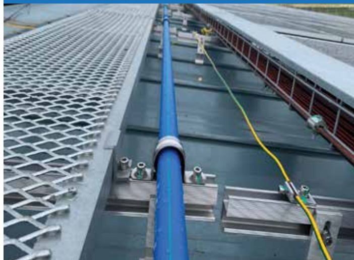
Hệ thống cấp nước vệ sinh
